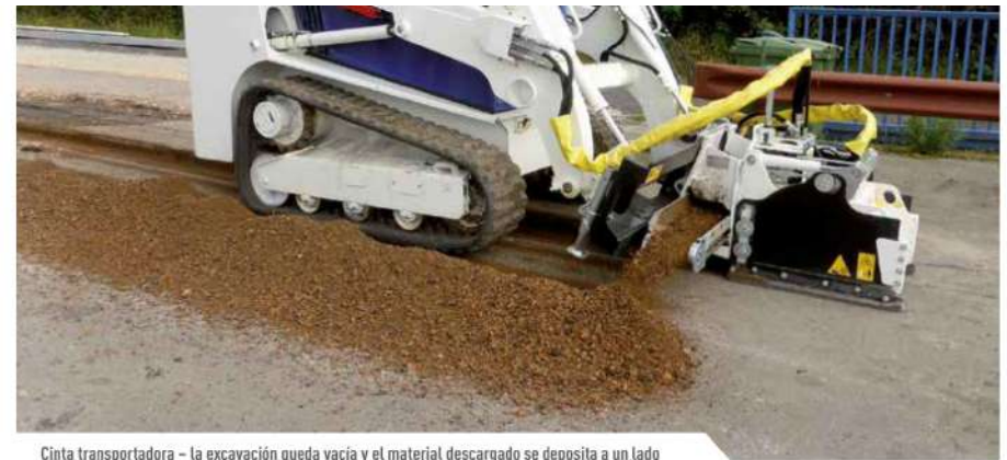
Cinta transportadora - la excavación queda vacía y el material descargado se deposita a un lado
